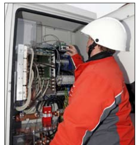
Prüfung des Steuerschranks durch Serviceteamleiter Olaf Braun.
