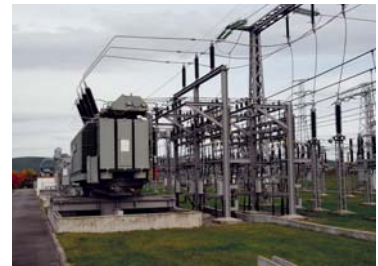
Einsatz Leittechnik SAT 250. BILD OBEN
