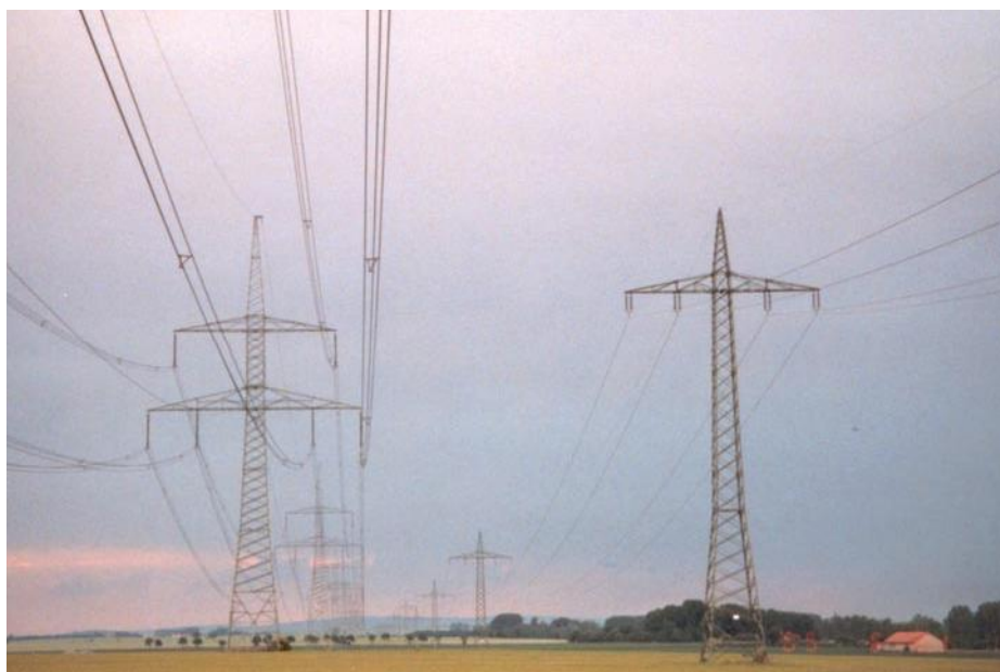
Bild 12: Leitungen der Wiedervereinigung, Nähe Gotha, 380 kV, 50 Hz u. 110 kV, 16 2/3 Hz“.
