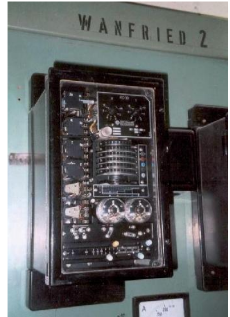
Bild 4: Distanzschutz RD10, EAW, UW Katharinenberg, 30-kV-Leitung Wanfried
