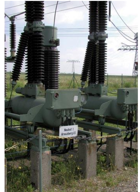
Bild 8: UW Wolkranshausen, 110-kV-Schaltfeld Neuhof
