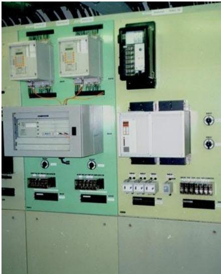
Bild 14: Schutz UW Remptendorf, Abg. Redwitz 253/254, Hauptschutz Distanzrelais PD551 mit AWE-Zusatz RM1-80, AEG und Reserveschutz Leitungsdiff. TSD512 mit Signalübertragungsgerät SWT2000D, Siemens
