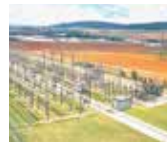
1995: Inbetriebnahme 110/20-kV-Umspannwerkes der TEAG in Eisenach
