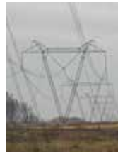
1985: Die 2 412 km lange 1.150-kV-Leitung zwischen Ekibastus und Tscheljabinsk (SU) nimmt bis Kustanaj den Betrieb auf.
