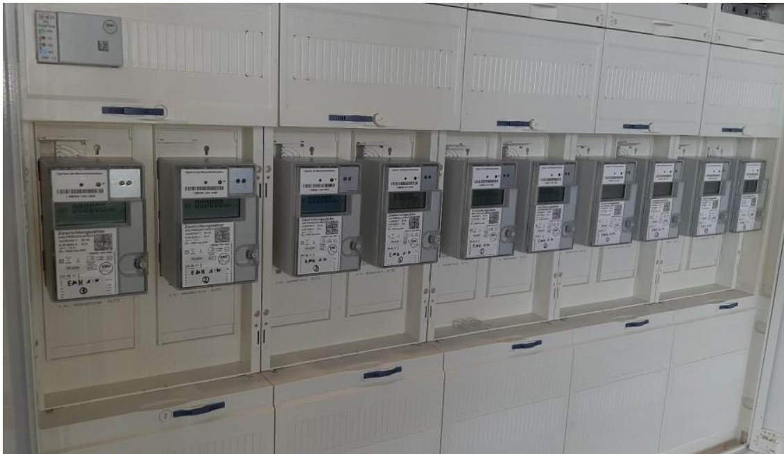
Quelle: Netze BW GmbH
