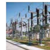
1999 Inbetriebnahme 110/20-kV-Umspannwerk Farnroda, TEAG
